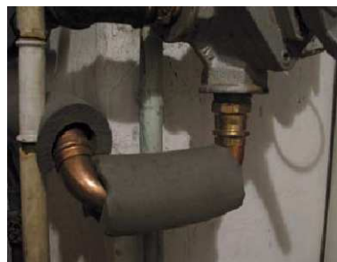
Neadekvatno izolirane instalacije sistema grijanja
